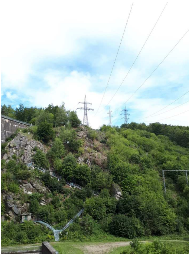
110-kV-Leitung Ottenstein-Zwettl der Netz Niederösterreich
