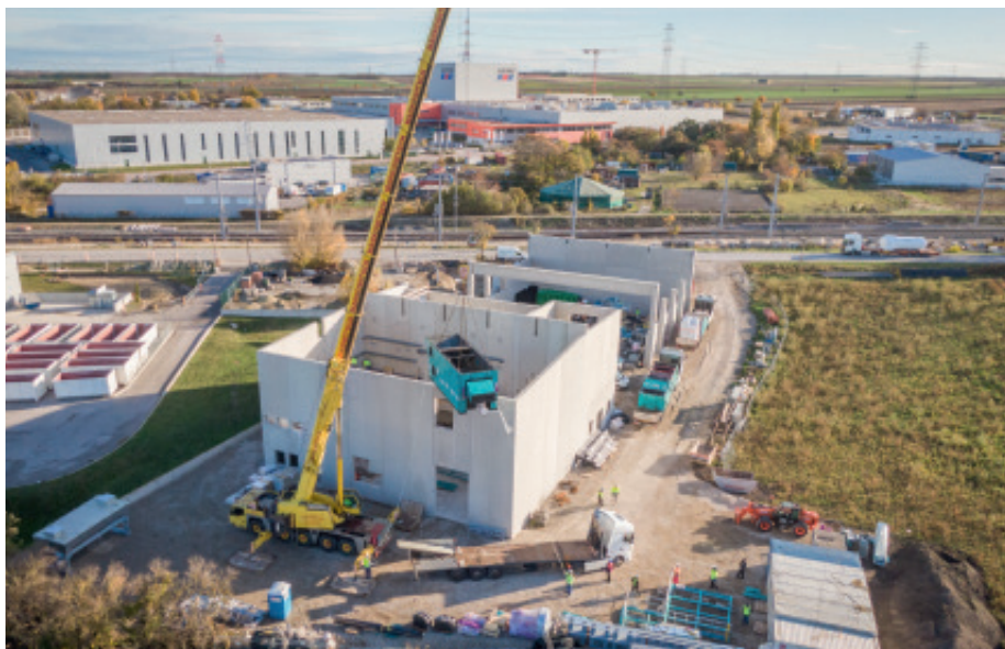
Die neue Anlage wird künftig rund 1.800 Haushalte mit nachhaltiger Wärme versorgen.
