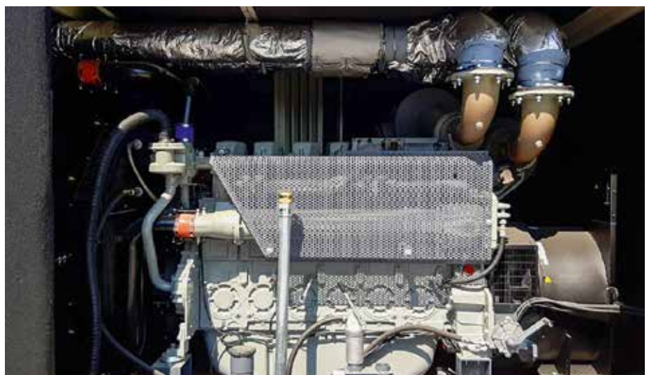
Die Fernwärmeversorgung in Wr. Neustadt wurde mithilfe eines Notstromaggregats „Blackout-tauglich“ gemacht. Die Versorgung von kritischer Infrastruktur ist damit gesichert.
