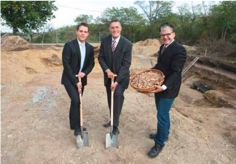
v.l.n.r.: EVN Projektleiter Dominik Jarmer, Bürgermeister Ludwig Deltl und Prokurist der EVN Wärme Andreas Oberhammer beim Spatenstich für das neue Biomassefernh Heizwerk
