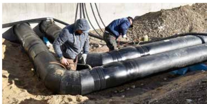
Auch die Leitungen für Vor- und Rücklauf und damit auch der Anschluss an das Fernwärmenetz sind bereits vorbereitet.
