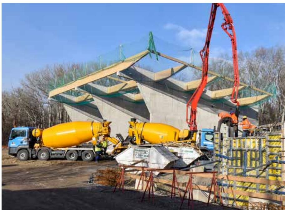
Zwischen dem Krafthaus (rechts) und dem Hackgutlager (links) entsteht ein Löschwasserbecken mit einem Fassungsvermögen von 400 m 3 .
